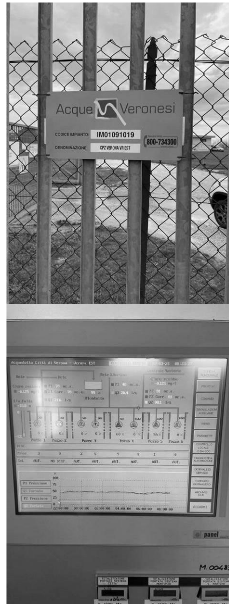
Figura 2-1 - Targa dell'impianto – sistema di telecontrollo.
