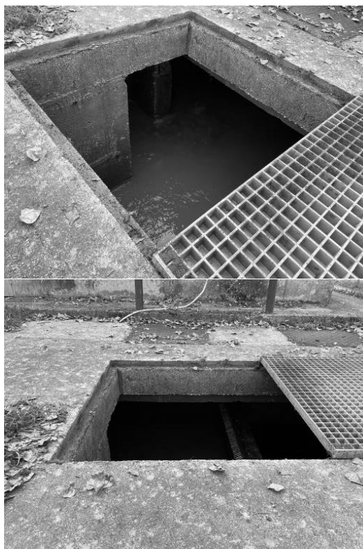
Figura 2-11: Sfiatore in testa all'impianto di Tremolè – Comune di Pescantina e codifica impianto di depurazione.
